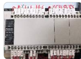
PLC控制系统 PLC Control System
